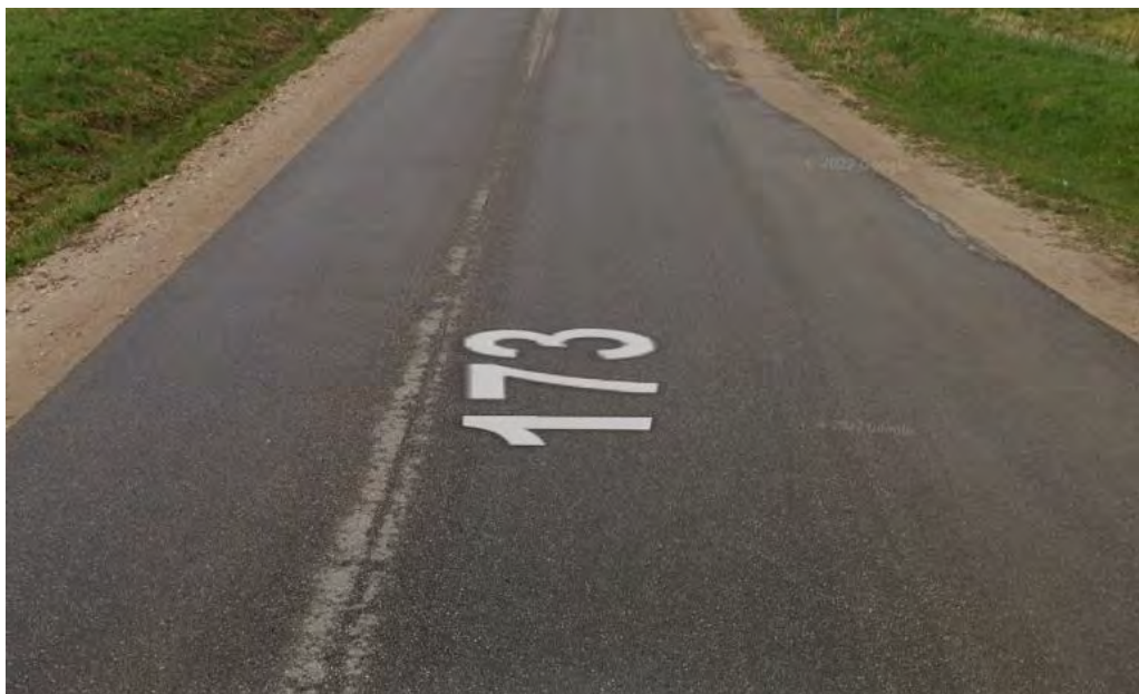
2 pav. Važiuojamosios dalies kraštų nutrupėjimas
