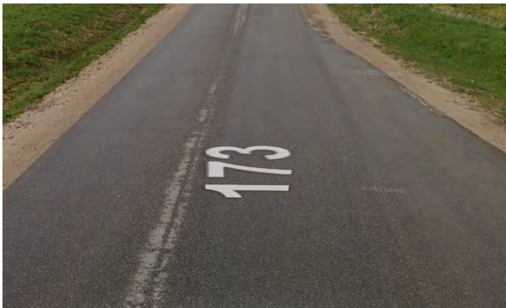
2 pav. Važiuojamosios dalies kraštų nutrupėjimas
